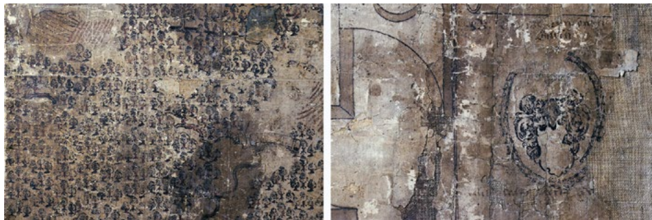
Il. 4. Nawarstwienia klejów, zabrudzeń i zacieki obecne głównie w uszkodzonych obszarach mapy, bryty 8 i 3 (fot. Jolanta Czuczko)
